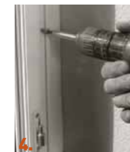
4. Fixation du nouveau dormant par vérins réglables ou par vissage en applique et réalisation d'une étanchéité périphérique.
